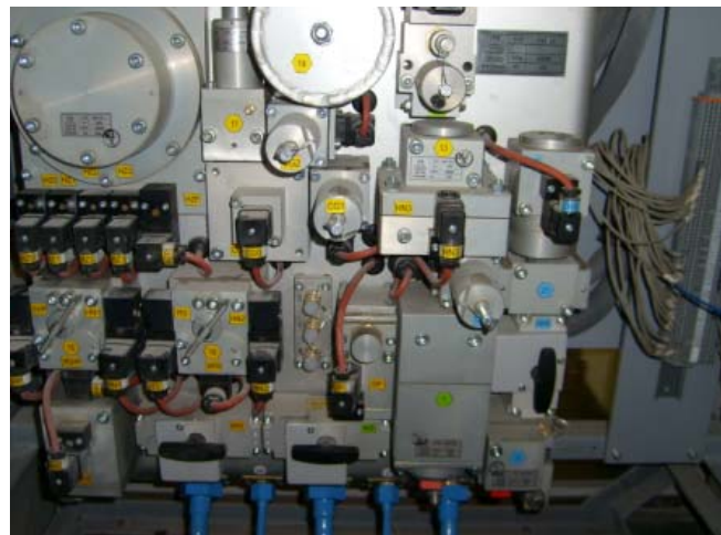
Rys. 20. Widok na tablicę aparatów elektropneumatycznych i pneumatycznych w zmodernizowanym zespole EW60
