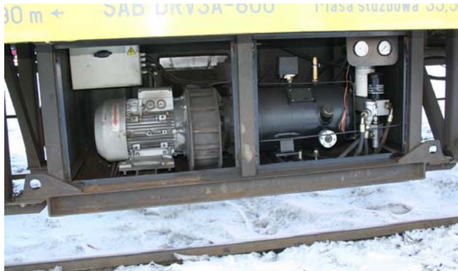
Rys. 19. Widok na zabudowany agregat sprężarkowy
