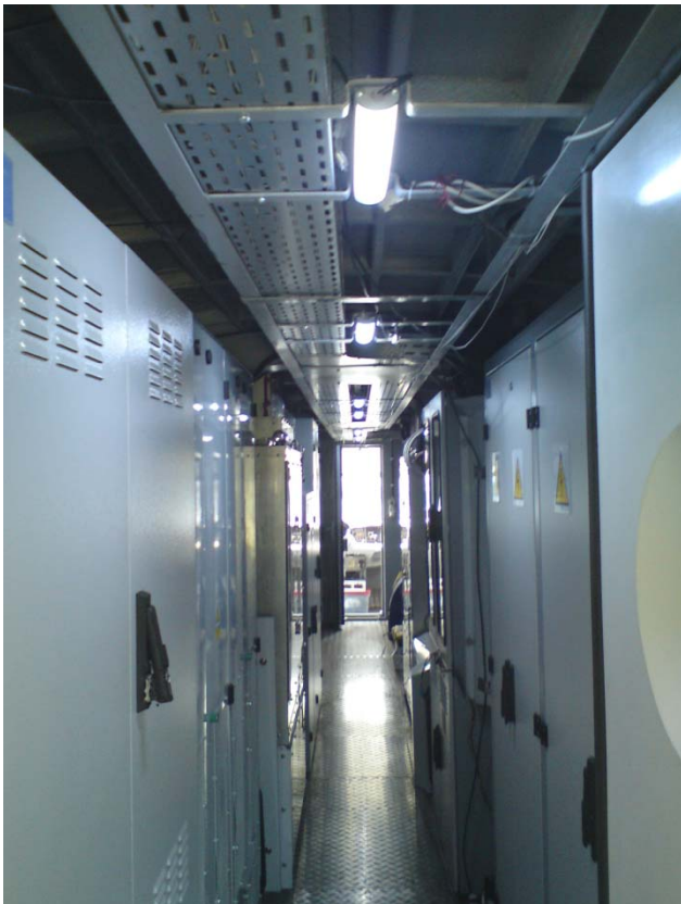
Fot. 4 Korytarz przedziału maszynowego z oprawami oświetleniowymi LED [fot. autor]
