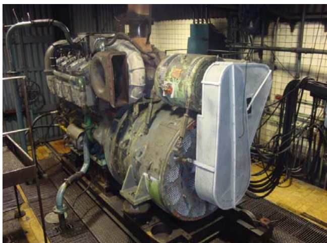
Ryc. 1. Agregat prądowórczy lokomotywy zainstalowany na hamowni
