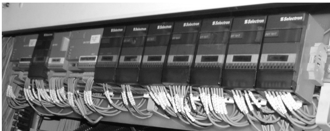
Rys. 2. Sterownik pneumatyki zmodernizowanej lokomotywy ST44
