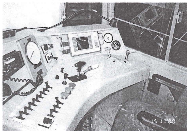
Fot. 2 Widok na pulpit i stanowisko sterowania-stan po modernizacji.
